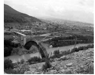
Pogled na gradbišče mostu čez Sočo s pobočja Sabotina junija 1984. PANG 647, Splošno gradbeno podjetje Primorje Ajdovščina, dia 10/8.
