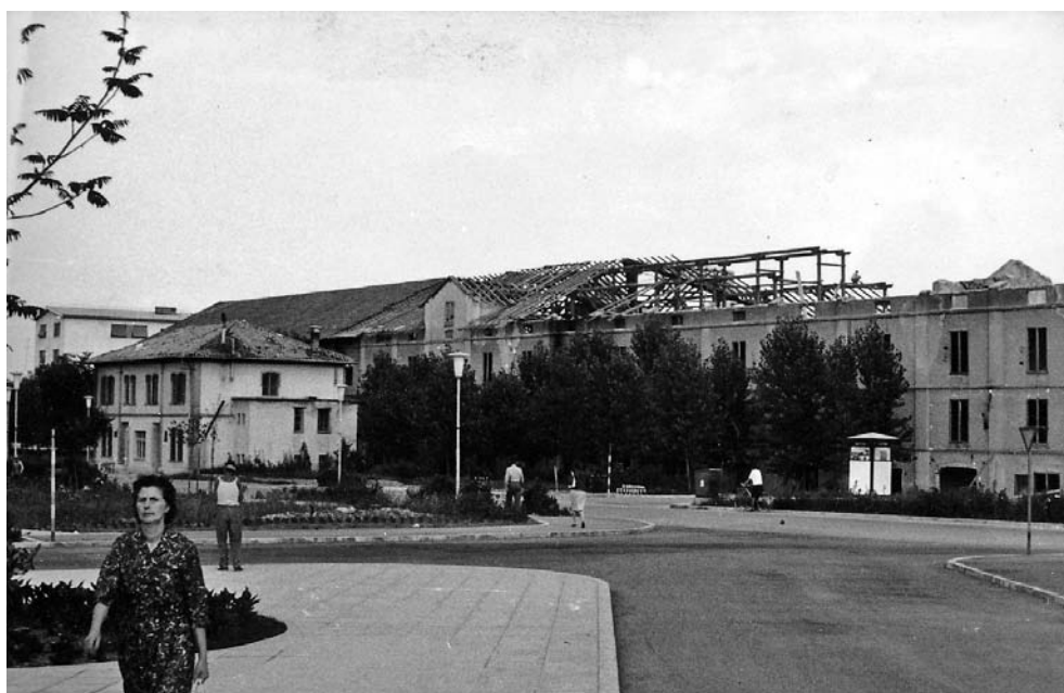
Podiranje strehe vzhodnega trakta opekarne, pogled z avtobusne postaje, 1964. PANG 583, a. e. 146/1.
